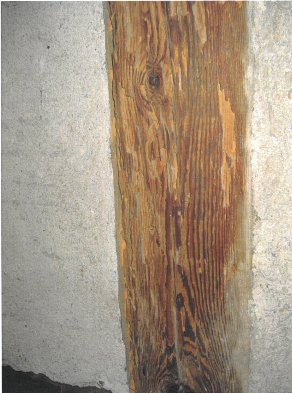
Holzwurmspuren an ein Fachwerkstütze im OG
