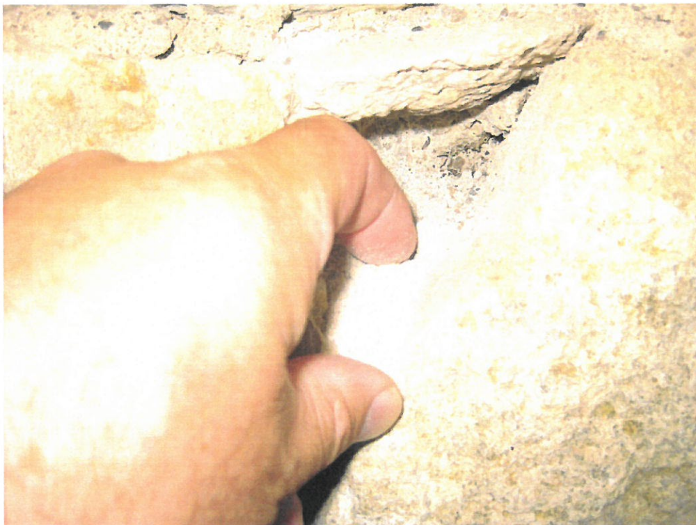
Lose Mörtelschichten im Bruchsteinmauerwerk.
