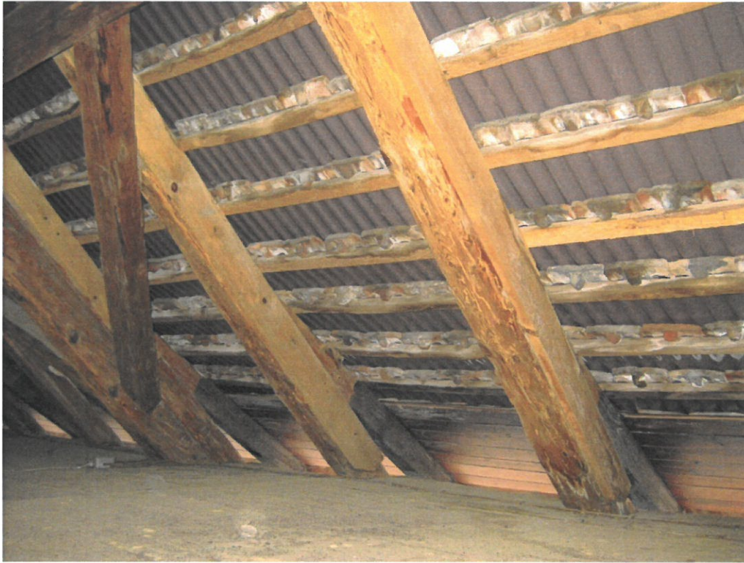
Holzwurm Spuren an der Dachkonstruktion.
