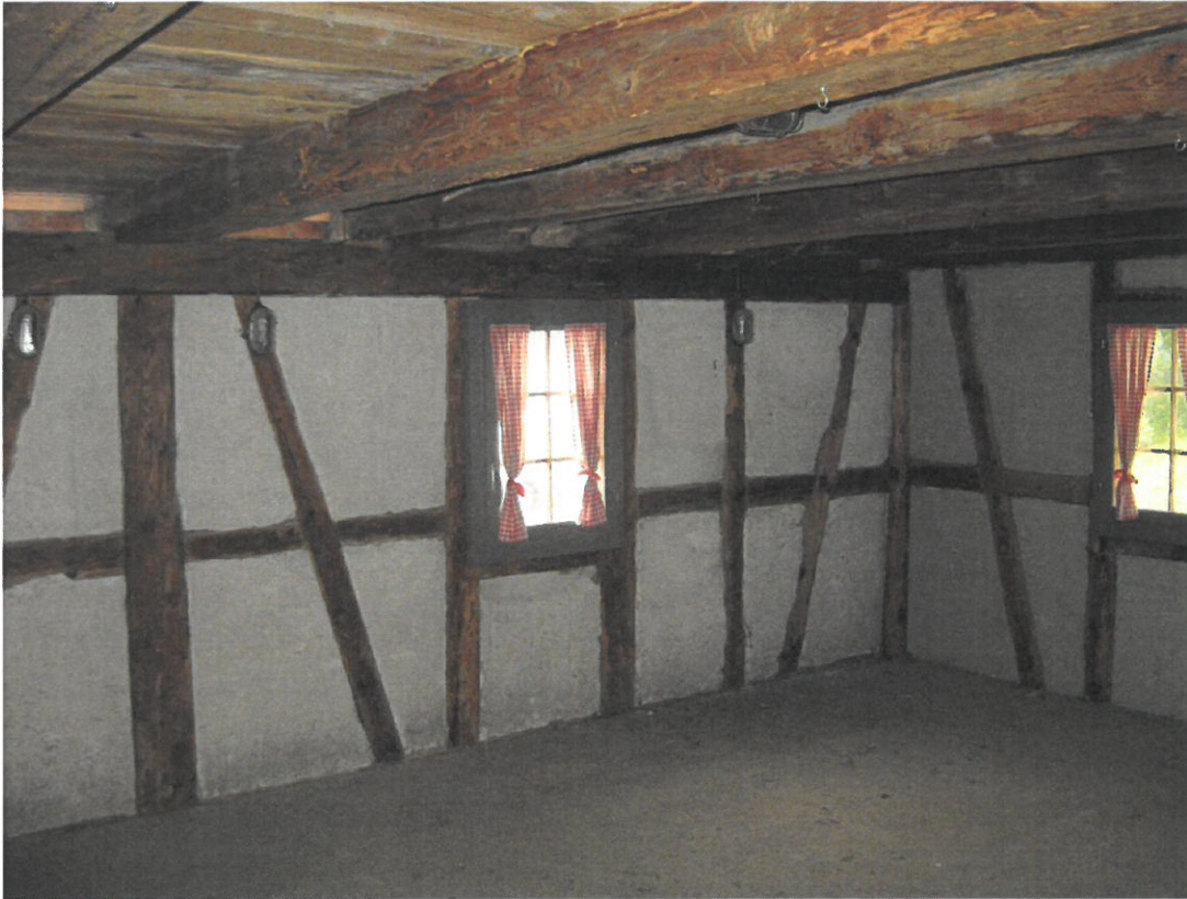
Ausfachung im OG und sichtbare Holzwurmpuren bei Holzbalken in der Decke über OG
