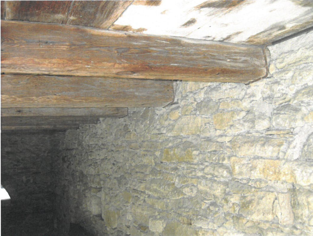
Natursteinmauerwerk und Holzdecke über EG. Verfaulte Holzdielen zwischen Holzbalken
